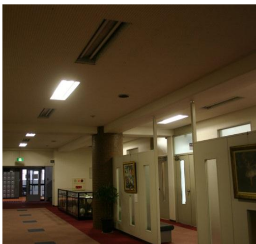
本館1階部分照明の2基点灯
